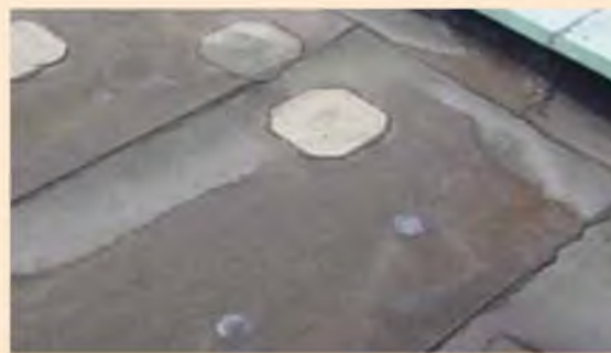
Przykład uszkodzonego dachu
